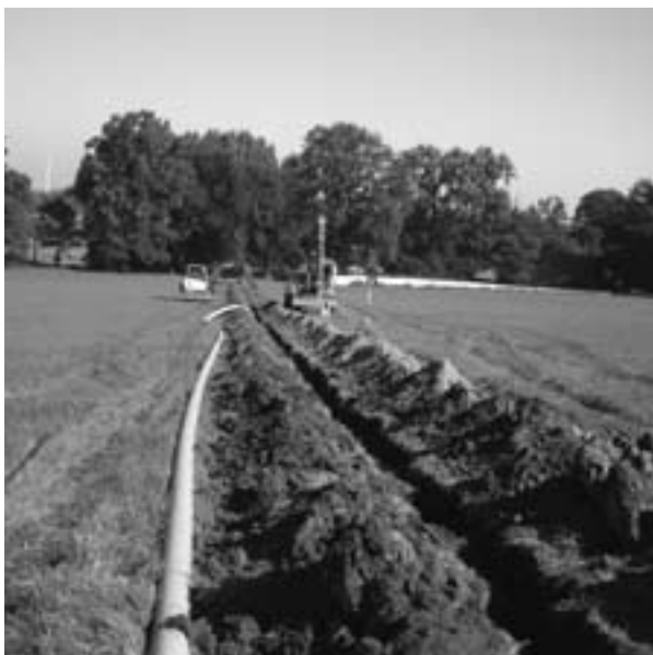
Eigene Biogasleitung zum dezentralen BHKW
